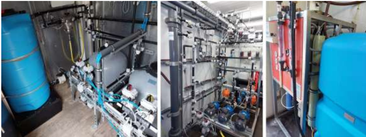
Abb. 2 Fotos der drei Filtrationseinheiten der Pilotanlage Membranfiltration: Vorfiltration über zwei Hydroanthrazit-Filter (links), Ultrafiltrationseinheit (Hohlfasermodule Liqui-Flux W06-08N, 3M) mit Zulauf- und Rückspülpumpen (Mitte) und Umkehrosmoseeinheit (rechts: drei Wickelmodule TML 10D, Toray)
