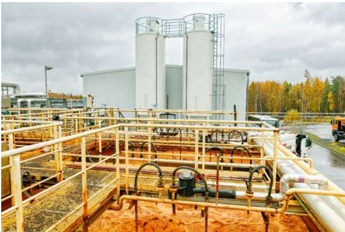
Abb. 2 Neutralisationsstufe der Wasserbehandlungsanlage, im Hintergrund die beiden Kalksilos Fig. 2 Neutralisation stage of the water treatment plant, with the two lime silos in the background
