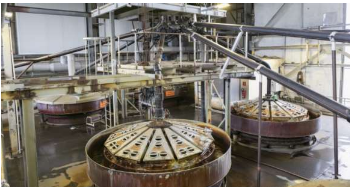
Abb. 1 Sorptionskolonne (Ionenaustauscher) der Uranentsorgung
