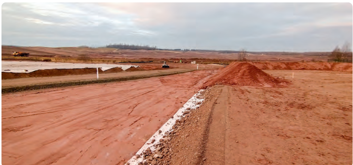
Getrennte Einlagerungsflächen für Immobilisat, Bauschutt und Schrott (v. l.) auf der IAA Culmitzsch im Becken A Dezember 2021
