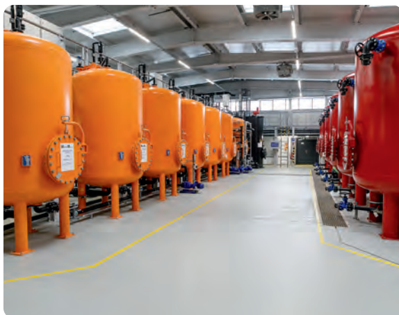
Austauscherkolonnen in der neuen WBA
