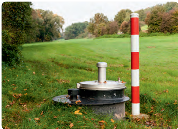
Wasserfassung im Wasseraustrittsgebiet Sprotte Posterstein
