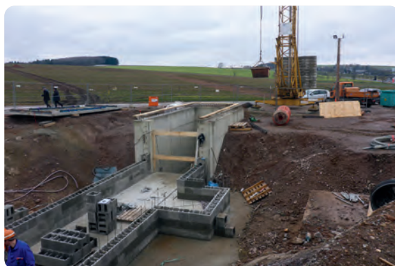
Aufbau des Wetterkanals am Schacht 76
