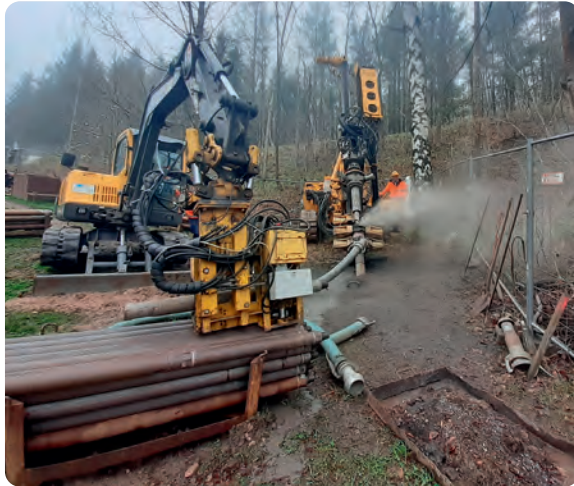
Im Bereich der Eichhörnchenquelle im Silberbachtal wurden die letzten tagesnahen Grubenhöhlräume verwahrt
