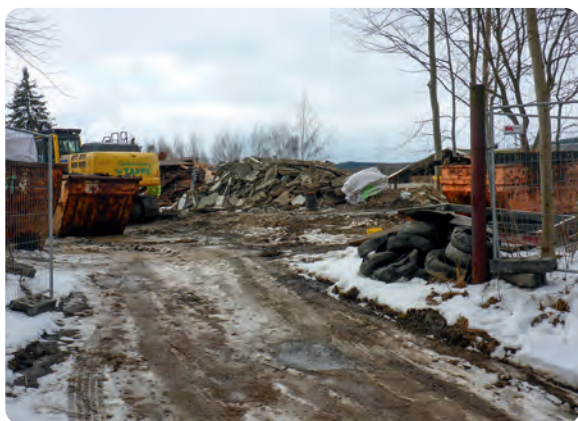
Der Abbruch der Garagen auf der Betriebsfläche Uranus I begann im Februar 2022
