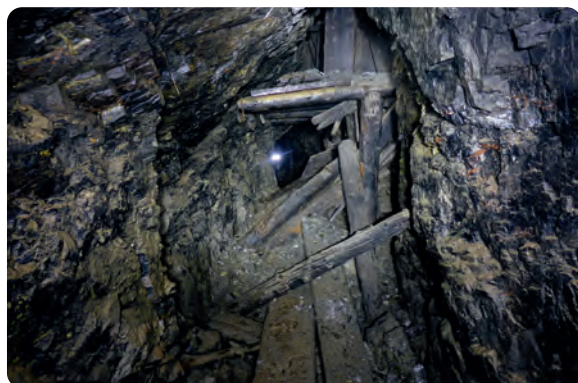
Hindernisse für die Wasserableitung im Stollen – Holzeinbauten der SAG Wismut
