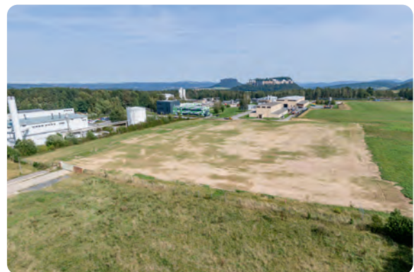
Jetzt ist auch die Flächensanierung beendet und das Gras beginnt zu wachsen
