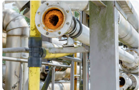
Die Rohre sind teilweise innen verkrustet wie auf dem Foto von 2021
