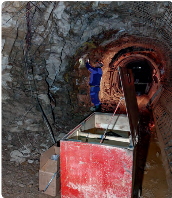
Besetzen der Sprengscheibe
