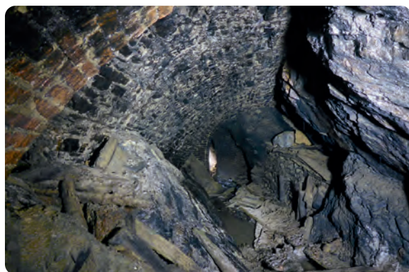
Unsanierter Stollenabschnitt bei der Schafstall Fundgrube
