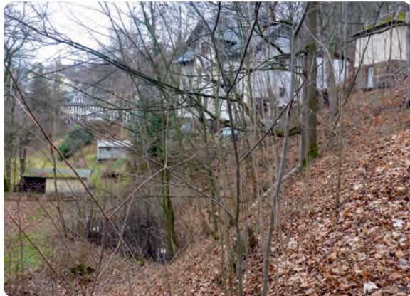
Tagesbruch unterhalb des Hangbebauung an der Waldschlößchenstraße
