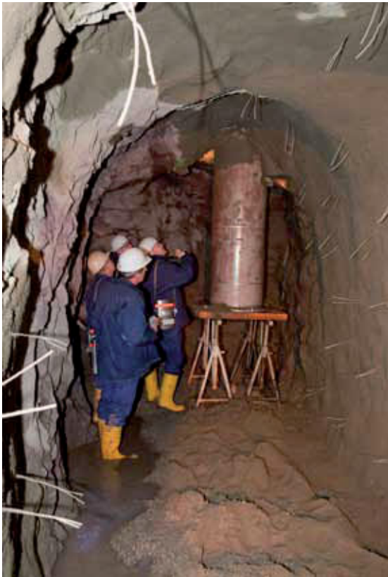
Unter Tage - Blick auf Verrohrung eines Förderbohrloches (Bild 4.1-1)
